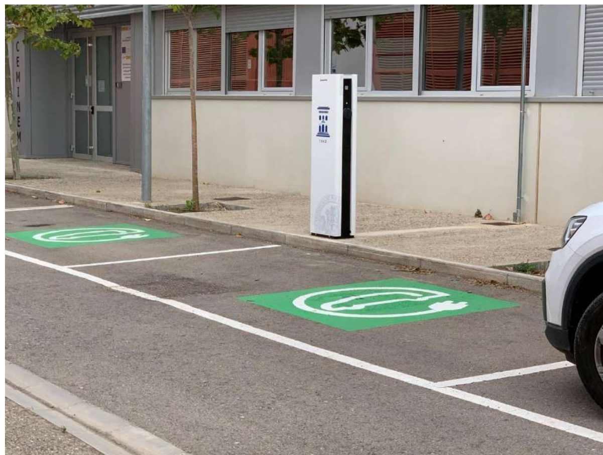
- EJEMPLO PUNTO DE RECARGA ELÉCTRICO PARA VEHÍCULO ELÉCTRICO -
